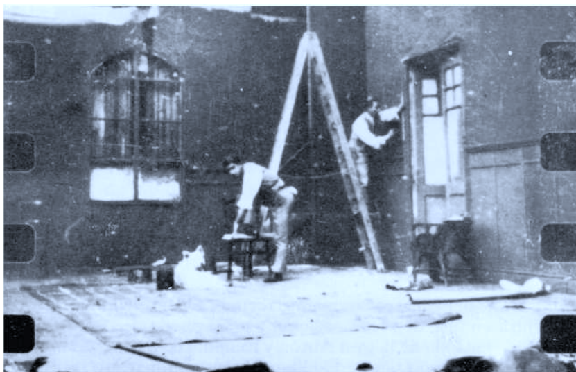
Construyendo los decorados de El Mayorazgo de Basterretxe de los hermanos Azcona
