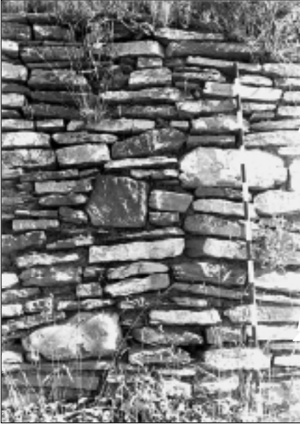
Fot. 1. Junta vertical casi continua. Lienzo entre la torre IX y la Poterna.
