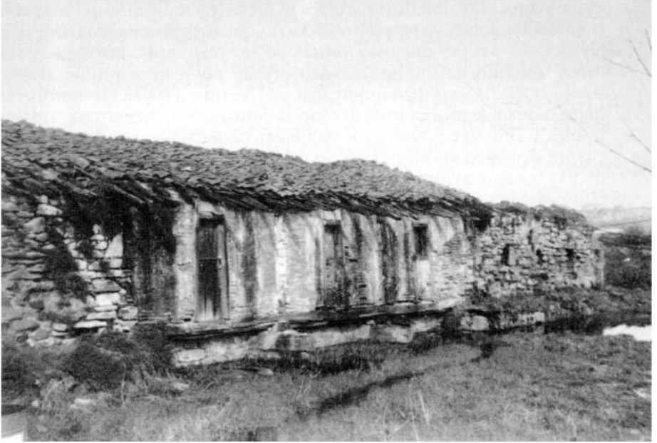
Foto 6.- Fachada Este con la balsa anegada.
