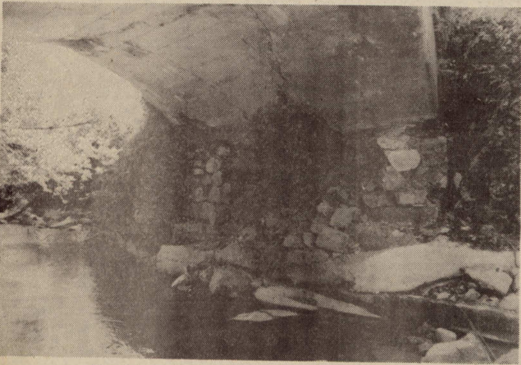
Así dejó la bomba el arco del puente de Tellería. (Foto MENA)
